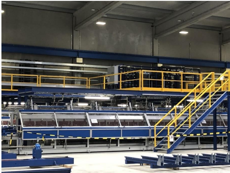
Image 4: L'installation ultramoderne de trempe et de revenu barre par barre est mise en service
